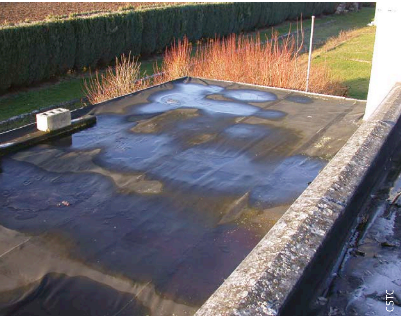
Fig. 28 Toiture froide endommagée par le pourrissement du support.
