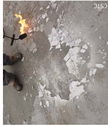
Fig. 110 Décohésion superficielle d'une forme de pente légère à base de ciment.
