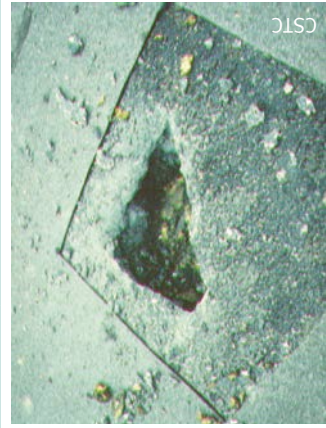
Fig. 106 Humidité dans un complexe toiture.
