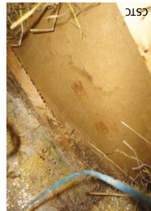
Fig. 114 Dégâts dus à la condensation interne dans une toiture compacte.
