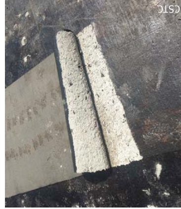
Fig. 111 Décohésion superficielle d'une forme de pente légère à base de ciment.
