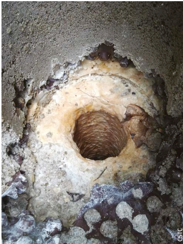
Fig. 93 Obstruction d'un avaloir par la chaux contenue dans le mortier de pose des dalles.
