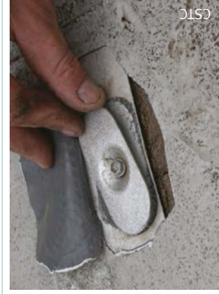
Fig. 103 Fixation mécanique instable.
