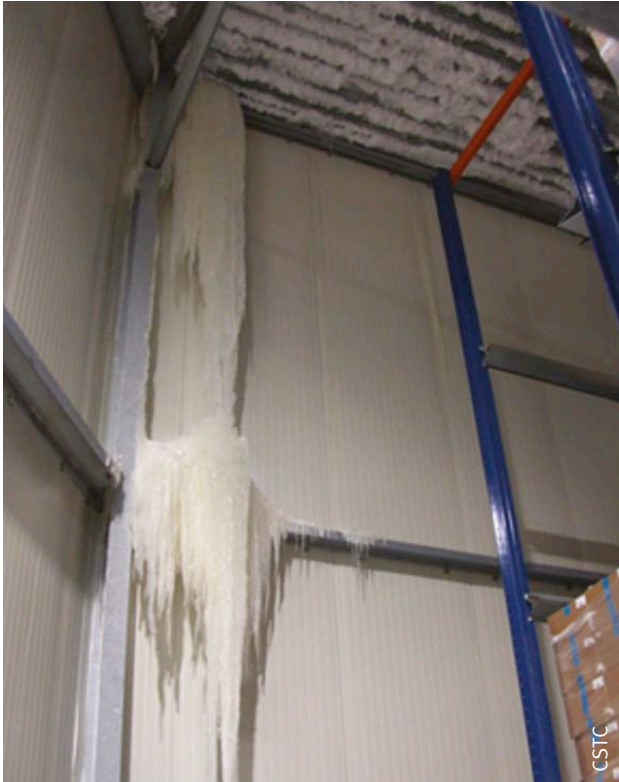
Fig. 36 Condensation en glace due à une fuite d'air dans une chambre frigorifique.
